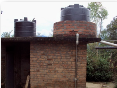
Réservoir de stockage d'eau
